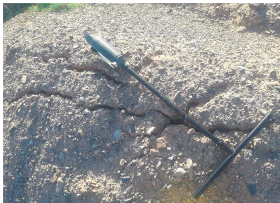
شکل ۱۲. ترک‌های کششی سطح باطله‌ها
