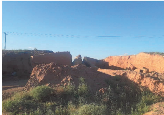
شکل ۱۰. تخریب ناشی از سیلاب‌های بزرگ
